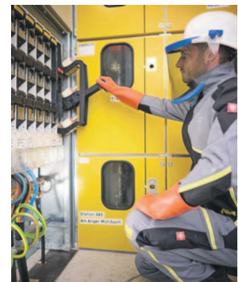
Bild: © Stadtwerke Fürstenfeldbruck: Neben der digitalen Analyse der Trafostationen, ist eine Kontrolle vor Ort wichtig.
